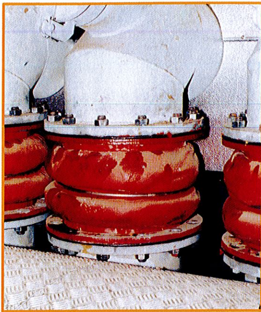
Müllverbrennung – Rauchgas Rezirkulation/Düsenkanäle
